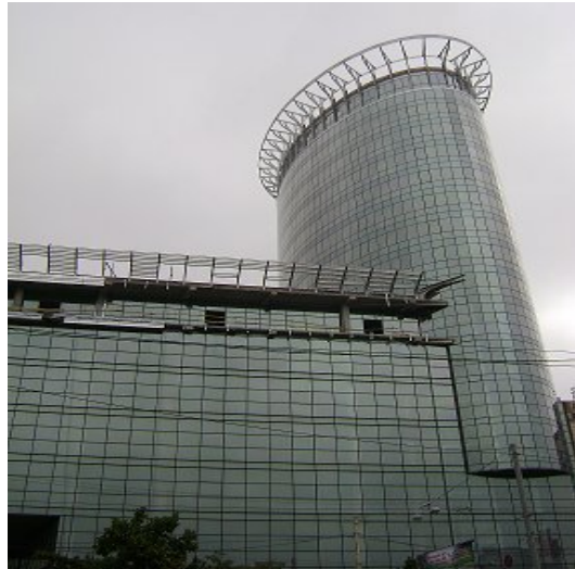
Хід робіт на об'єкті будівництва по вул. Мельникова, 2/10, станом на початок вересня 2010 року
