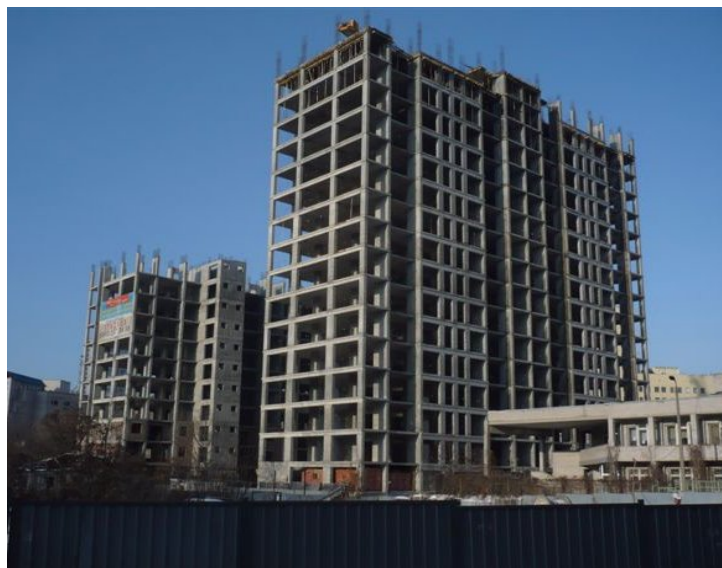
Хід робіт на об'єкті будівництва по пров. Ламаному в м. Дніпропетровську станом на 23.12.2009 р.
