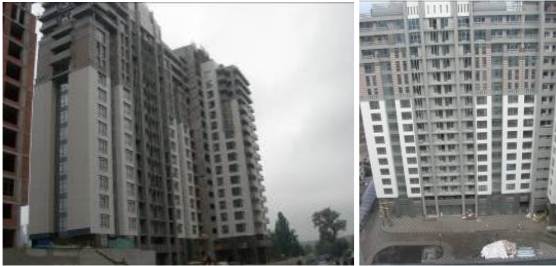
Хід робіт з будівництва ж/б 3 по вул. Професора Підвисоцького у Печерському районі м. Києва станом (зліва-направо): на 03.09.2009 р. та на 19.11.2009 р.
