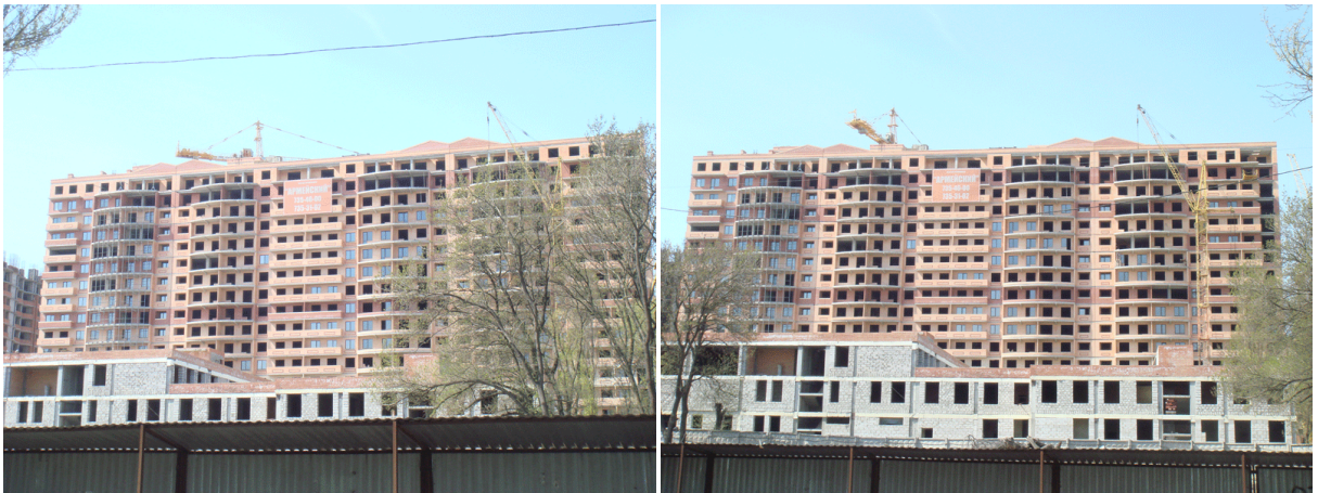
Будівництво 16-ти поверхового корпусу №1 житлового комплексу «Армійський» в м. Одесі станом на 01.05.2009 р.
