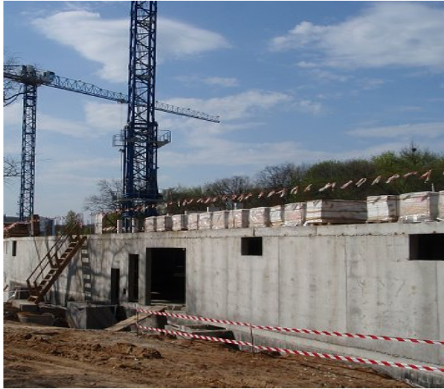
Стан будівництва житлового комплексу по вул. Фронтівій, 3 у м. Харкові станом на 02.08.2009 р.
