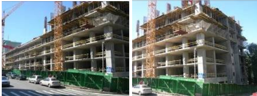
Будівельні роботи на об'єкті будівництва, обмеженого вулицями Предславинською, Ульянович та Червоноармійською станом на 04.06.2009 р.
