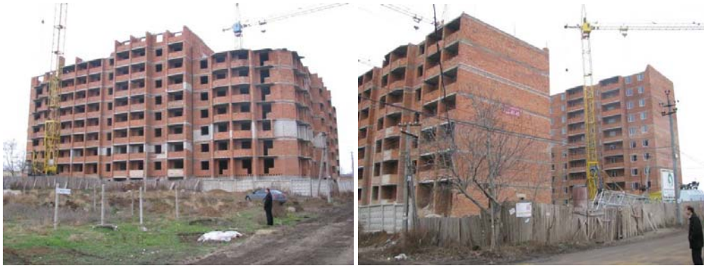
Рисунок Ошибка! Текст указанного стиля в документе отсутствует..1. Хід робіт на об'єкті будівництва по вул. Лабораторній в с. Мізінкевичі Овідіопольського району Одеської області станом на кінець 2008 року
