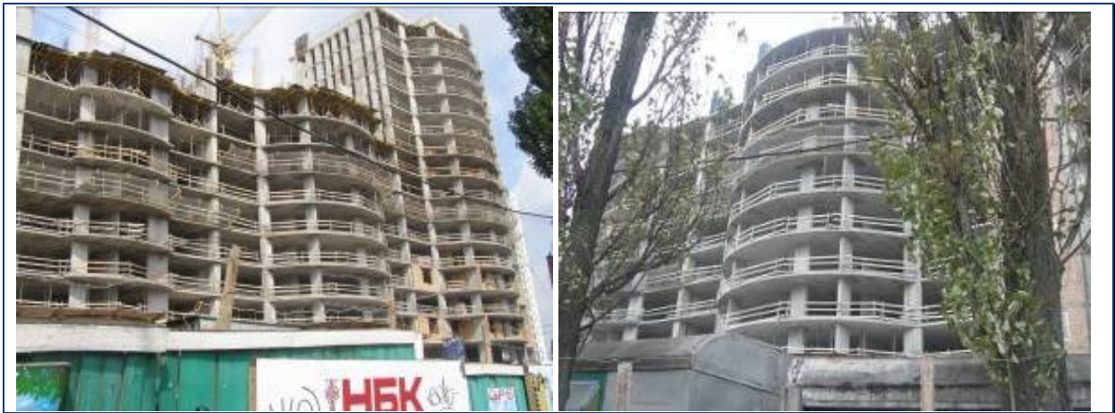
Будівельні роботи на секціях 1-3 житлового будинку № 26 станом на середину травня 2009 року та на початок листопада 2009 року
