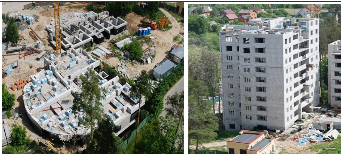
Будівництво житлового комплексу (II черга) по вул. Лобановського, 1 у с. Чайці Києво-Святошинського району Київської області станом на початок травня 2012 року (зліва на право: будинок №8, будинок №9)
