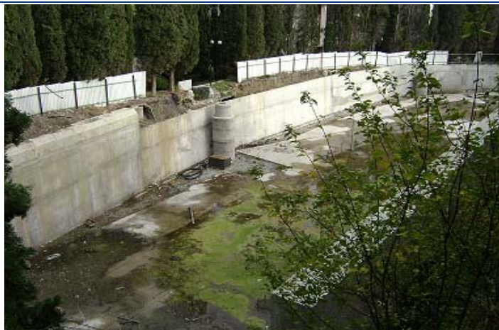
Стан будівництва за проектом реконструкції кінотеатру з добудовою рекреаційно-оздоровчого корпусу за адресою: АР Крим, смт. Гурзуф, вул. Ленінградська, 1 А станом на кінець квітня 2011 року
