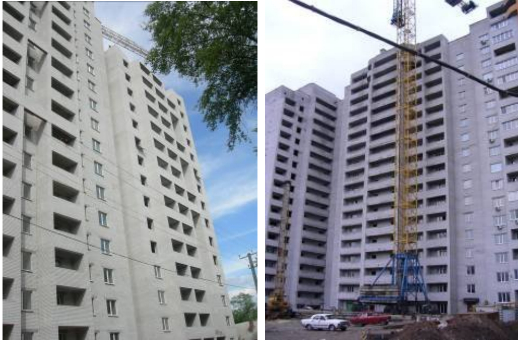
Об'єкт по вул. Дмитра Кедріна, в районі будинку №55 (III черга), м. Дніпропетровськ станом на кінець травня 2009 року та на грудень 2009 року.
