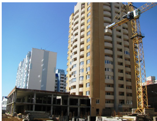
Рисунок 3. Стан будівництва громадсько-житлового комплексу по вул. М. Говорова, 10 А у м. Одесі на 18.06.2010 р.
