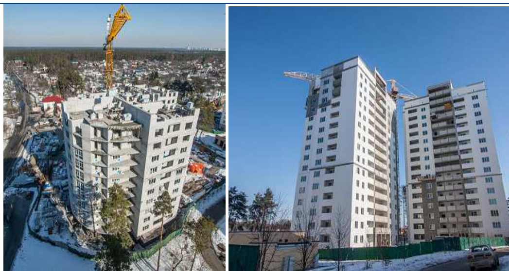
Будівництво житлового комплексу (II черга) по вул. Лобановського, 1 у с. Чайці Києво-Святошинського району Київської області станом на кінець лютого 2013 року (зліва на право: будинок №8, будинок №9)
