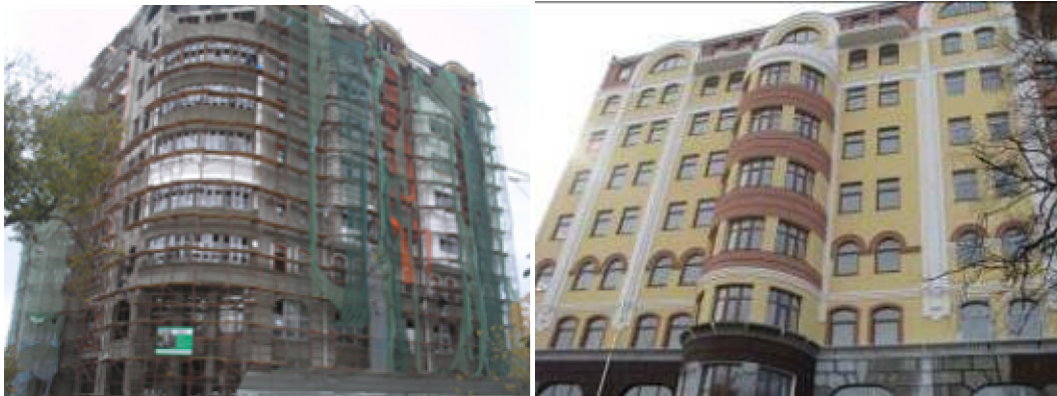
Рисунок 0.1. Хід робіт на об'єкті будівництва по вул. Баглікова у м. Алушті станом на початок листопада 2008 року та на середину лютого 2009 року
