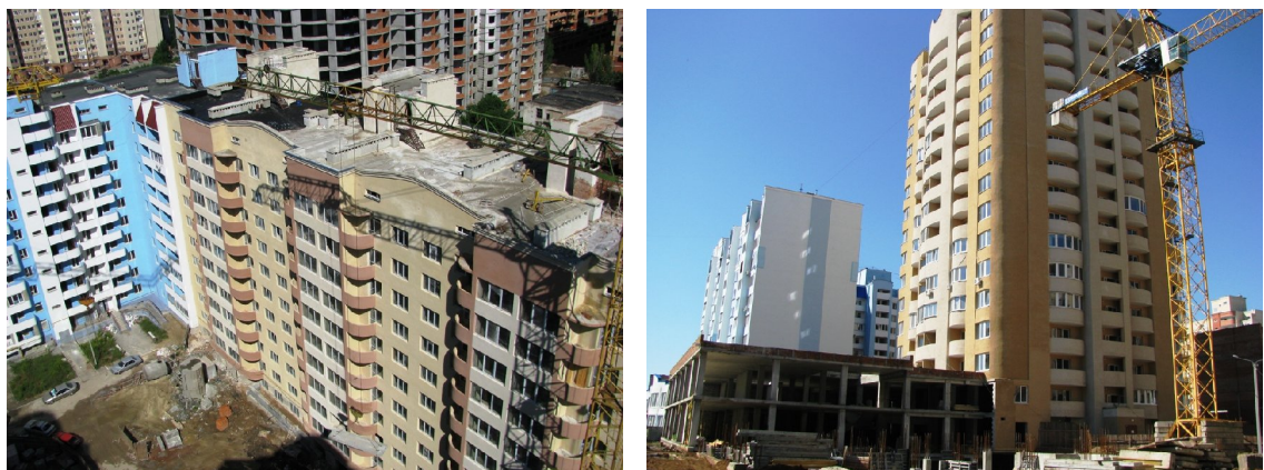
Рисунок 3. Стан будівництва громадсько-житлового комплексу по вул. М. Говорова, 10 А у м. Одесі на 18.06.2010 р.
