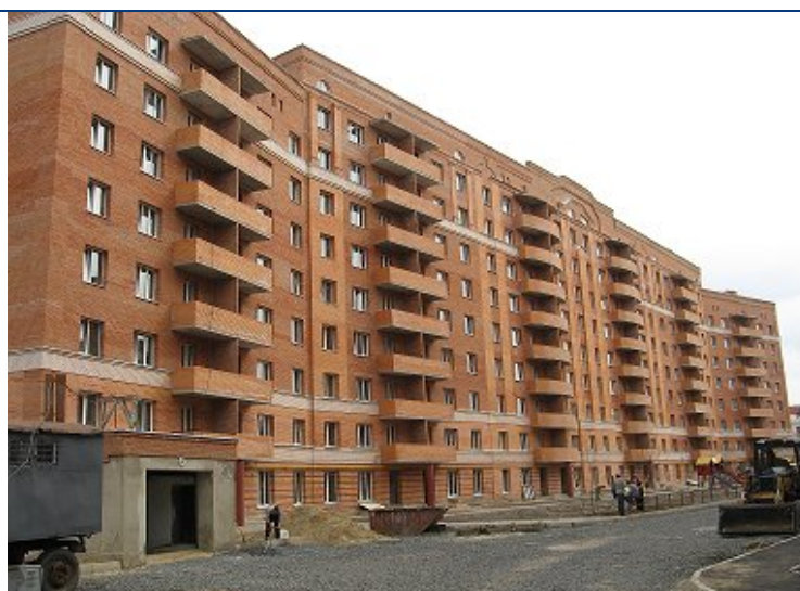
Житловий будинок по вул. Жовтневій, 40-Д у м. Полтаві, станом на 20.04.2010 р.
