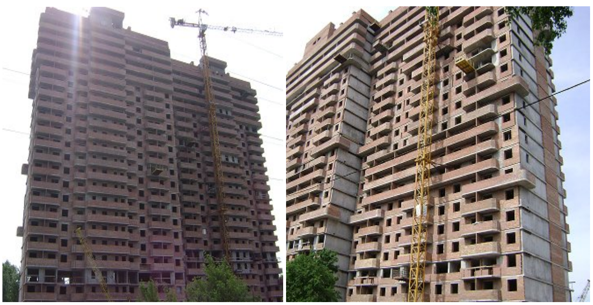
Будівельні роботи на об'єкті будівництва в м. Києві по вул. Генерала Наумова, 66 станом на 05.05.2009 р.
