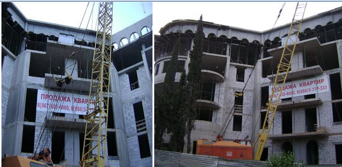
Стан будівництва житлового будинку по вул. Батуріна, 44А у смт. Лівадія м. Ялти станом на 04.06.2009 р.
