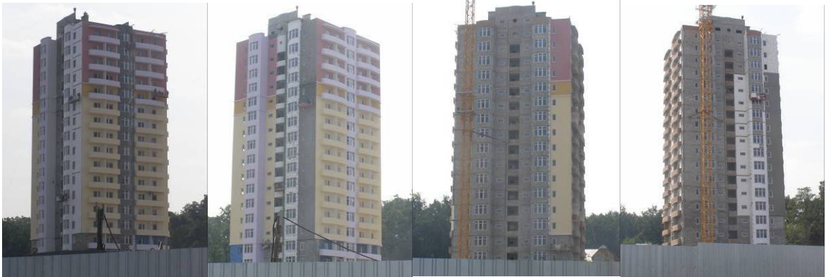
Стан будівництва житлового комплексу Grand Life в м. Ірпені Київської області станом на 28.08.2009 р.
