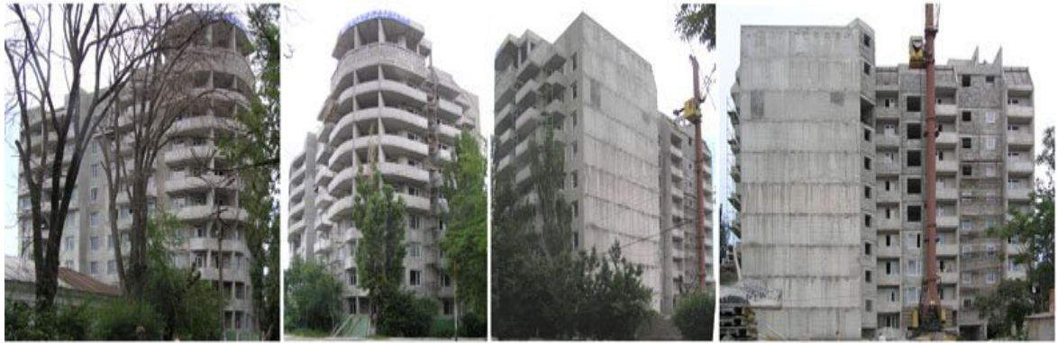
Рисунок 1. Будівельні роботи по вул. Вересаєва, 12 у м. Феодосії станом на початок серпня 2009 року
