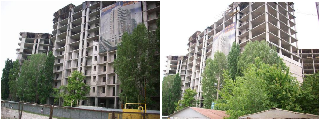
Рисунок 2. Будівництво житлового будинку по вул. Ак. Корольова, 5/2 у м. Одесі станом на кінець травня 2009 року
