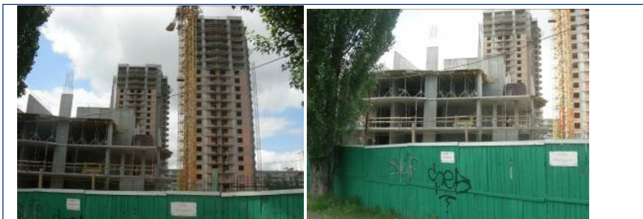
Рисунок 1.11. Будівельні роботи по житловим будинкам №№ 33 та 34 та № 35 станом на середину травня 2009 року
