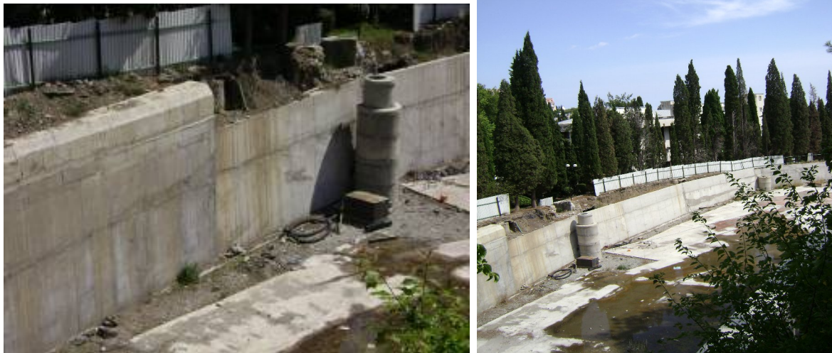
Стан будівництва за проектом реконструкції кінотеатру з добудовою рекреаційно-оздоровчого корпусу за адресою: АР Крим, смт. Гурзуф, вул. Ленінградська, 1 А станом на початок травня 2010 року та кінець серпня 2010 р.
