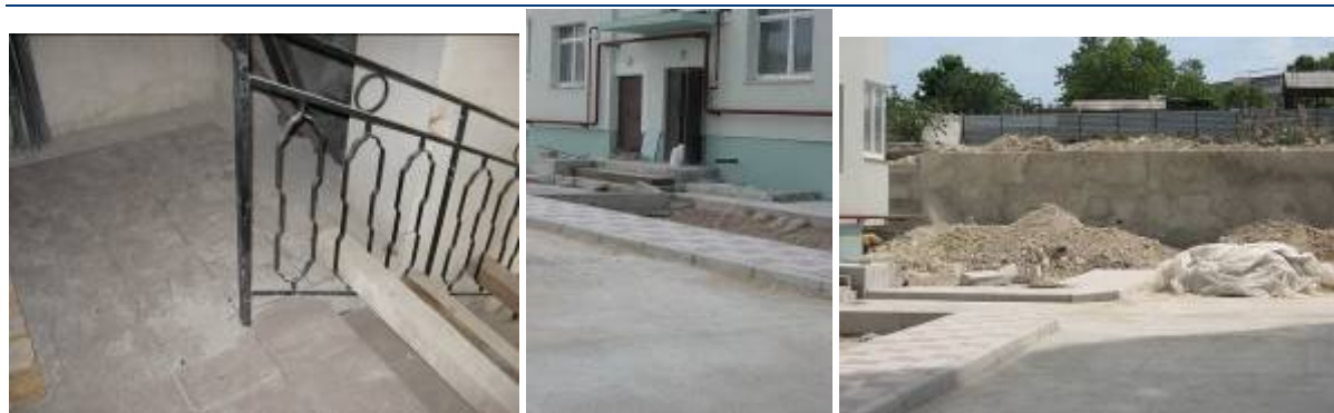
Рисунок 1.2. Стан будівництва 2-х житлових будинків по вул. Рєпіна, 19 у м. Севастополі станом на червень 2009 р.
