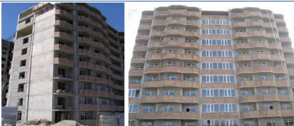
Рисунок 1.1. Стан будівництва 2-х житлових будинків по вул. Рєпіна, 19 у м. Севастополі станом на 05.09.2008 р. та станом на 25.10.2008 р.
