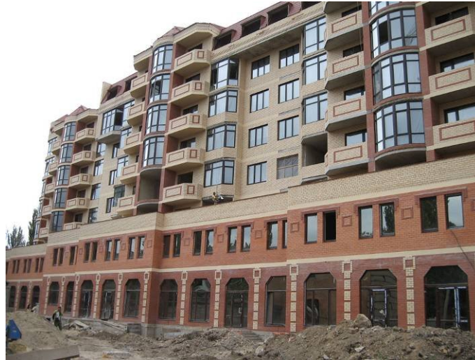
Будівництво 7-ми поверхового корпусу житлового комплексу «Армійський» в м. Одесі станом на 31.08.2009 р.
