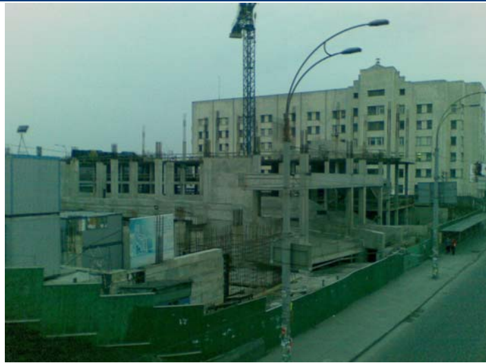
Стан будівництва офісної будівлі за адресою: м. Київ, пров. Індустріальний, 1-А на початок червня 2011 року.
