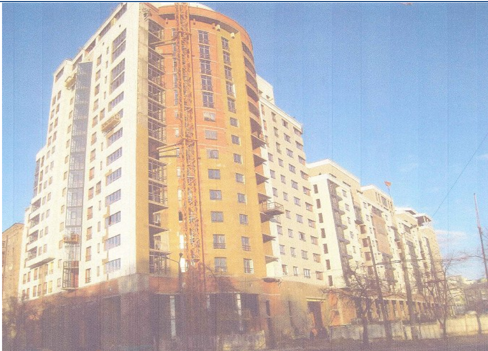
Хід робіт на об'єкті будівництва по пров. Банному в м. Харкові станом на 25.10.2009 р.
