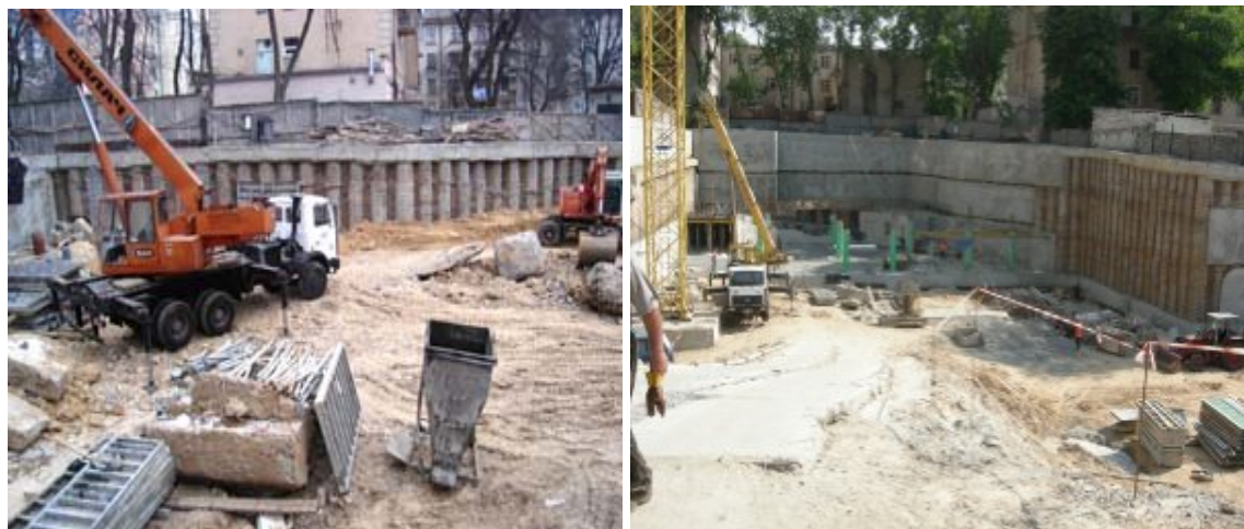
Рисунок 0.2. Хід робіт з будівництва багатоповерхового житлового по вул. Білоруській, 36-а у Шевченківському районі м. Києва станом на (зліва - направо) початок березня 2008 року та початок червня 2008 року
