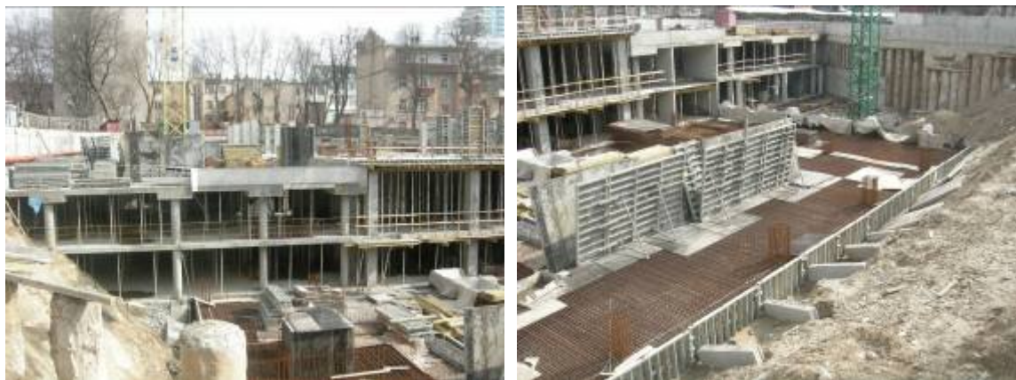
Рисунок 0.4. Хід робіт з будівництва багатоповерхового житлового будинку з вбудовано-прибудованими приміщеннями громадського призначення та підземного паркінгу по вул. Білоруській, 36-а у Шевченківському районі м. Києва станом на кінець березня 2009 року та на червень 2009 року
