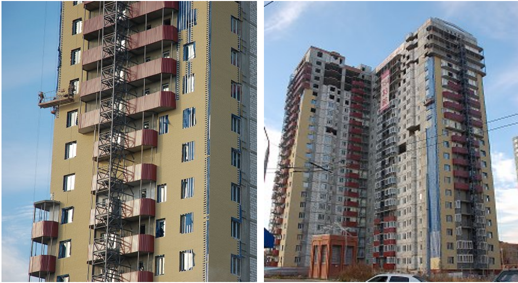
Хід робіт на об'єкті будівництва по вул. 23 Серпня (в районі буд. 31) у м. Харкові станом на 15.01.2009 р.
