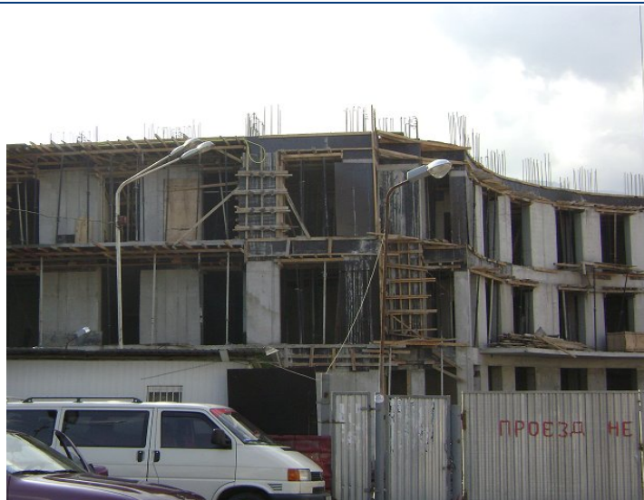
Хід робіт на об'єкті будівництва по вул. Ігнатенко, 9 у м. Ялті станом на 21.08.2009 р.
