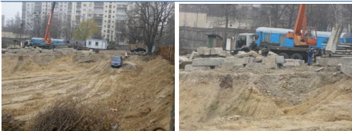
Хід робіт на об'єкті будівництва житлово-офісного комплексу з вбудовано-прибудованими торговельними приміщеннями, закладами громадського харчування та підземною автостоянкою по вул. М. Островського, 40 у м. Києві станом на листопад 2010 р.
