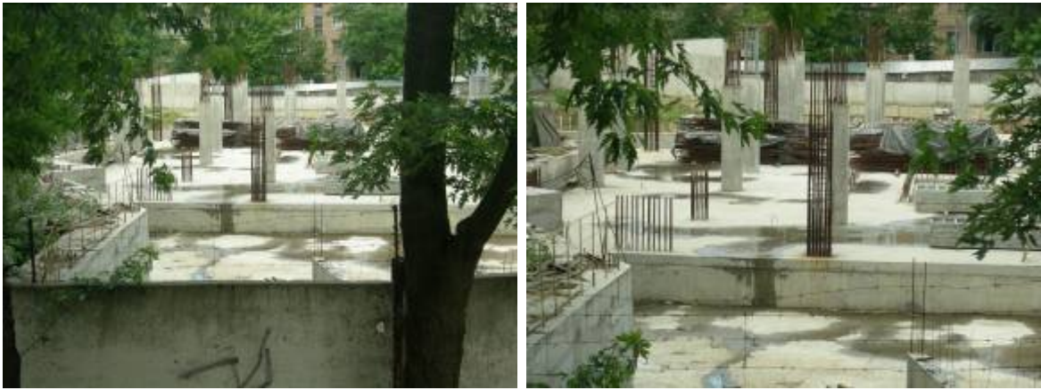
Об'єкт будівництва - багатоповерховий житловий будинок з вбудовано-прибудованими приміщеннями громадського призначення та підземний паркінг по вул. Білоруській, 36-а у Шевченківському районі м. Києва
