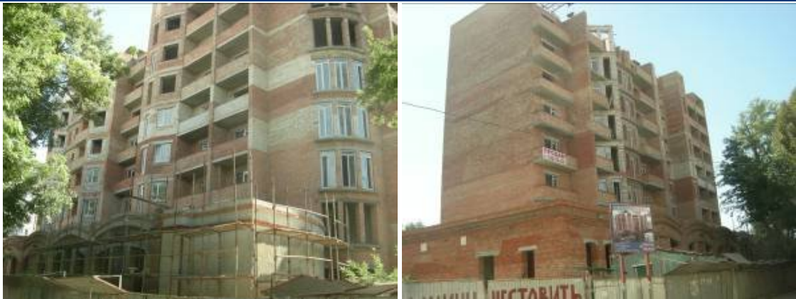
Будівництво житлового будинку по пров. Черепанових, 12 у м. Одесі станом на серпень 2010 року
