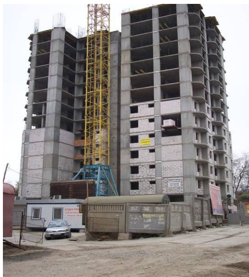
Рисунок 3. Стан будівельної готовності житлового будинку № 36 у мікрорайоні «Д» Південний у м. Одесі
