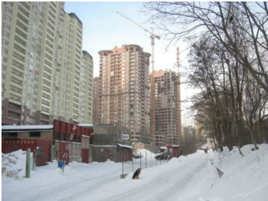
Рисунок 2. Будівельні роботи на об'єкті будівництва житлового комплексу по вул. Механізаторів, 2 (ж/к «Ізумрудний») у Солом'янському районі м. Києва станом на березень 2010 р.
