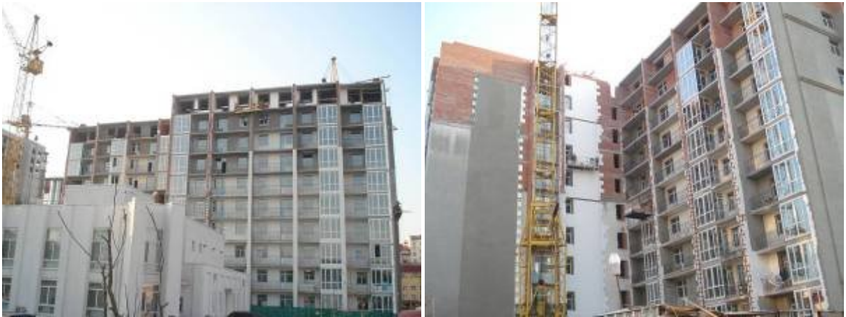
Будівництво житлового комплексу (II черга) в Київській області с. Чайки по вул. Лобановського, 1 станом на 27.04.2009 р.
