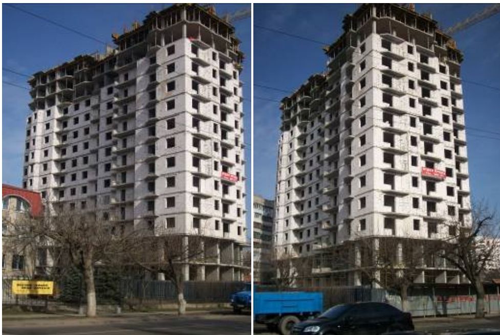
Хід робіт на об'єкті будівництва по вул. Малиновського (на розі вул. Заводської та пров. Союзного) в м. Одесі станом на початок березня 2010 р.
