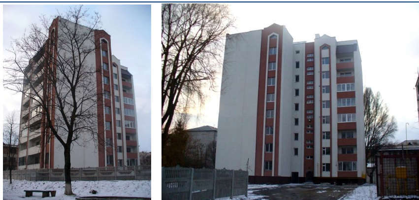
Хід робіт на об'єкті будівництва по вул. Злуки у м. Тернополі станом на 25.03.2009 р.
