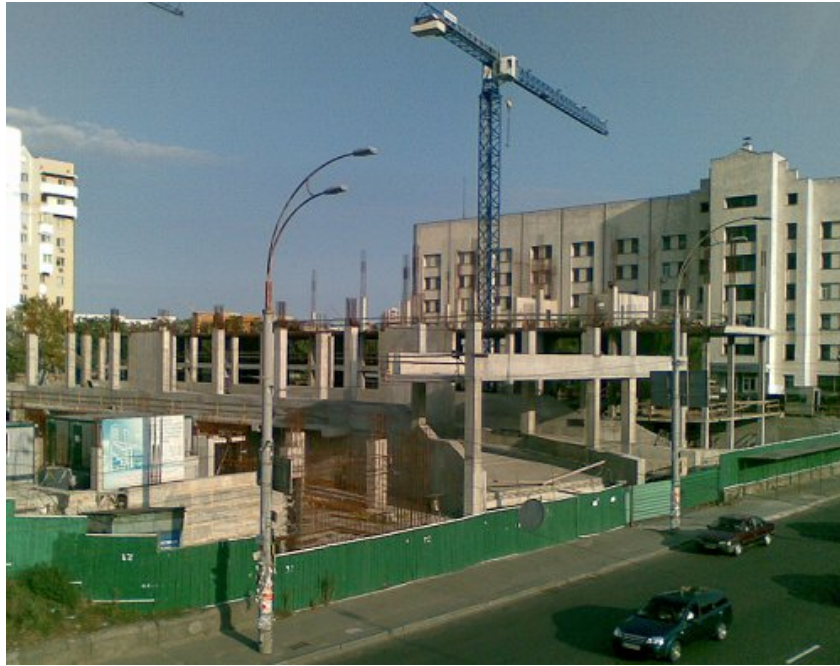
Стан будівництва офісної будівлі за адресою: м. Київ, пров. Індустріальний, 1-А на 10.08.2010 р.
