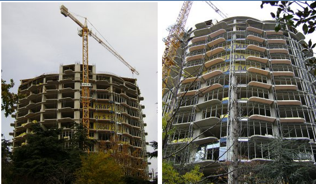
Будівництво багатоповерхового житлового будинку по вул. К. Маркса, 18а у м. Ялті станом на 11.11.2010 р.
