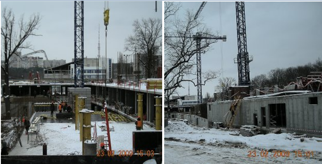
Стан будівництва житлового комплексу по вул. Фронтівій, 3 у м. Харкові станом на 23.02.2009 р.
