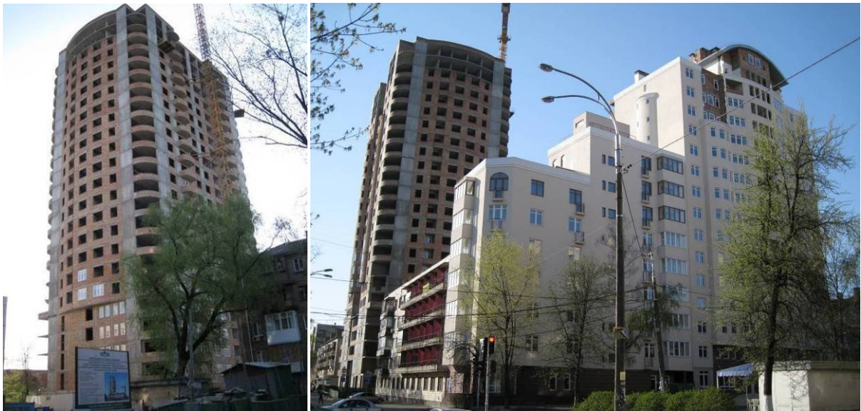
Стан будівництва житлових будинків №№1, 2, 4 по вул. М. Кривоноса та Климентя на 21.04.2009 р.
