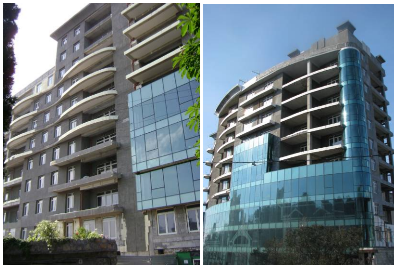
Хід робіт на об'єкті будівництва житлового комплексу «Адміралтейський» класу «люкс» по вул. Руданського, буд. 8 Б станом на кінець серпня 2009 року
