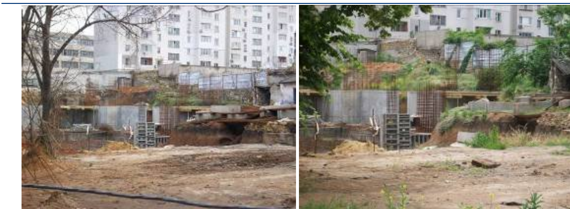
Хід робіт з будівництва житлового будинку по вул. Головківській, 5, 7 у м. Одесі станом на 20.02.2009 р. та станом на 29.05.2009 р.
