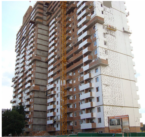
Рисунок 1. Будівельні роботи на об'єкті будівництва в м. Києві по вул. Генерала Наумова, 66 станом на 10.08.2009 р.
