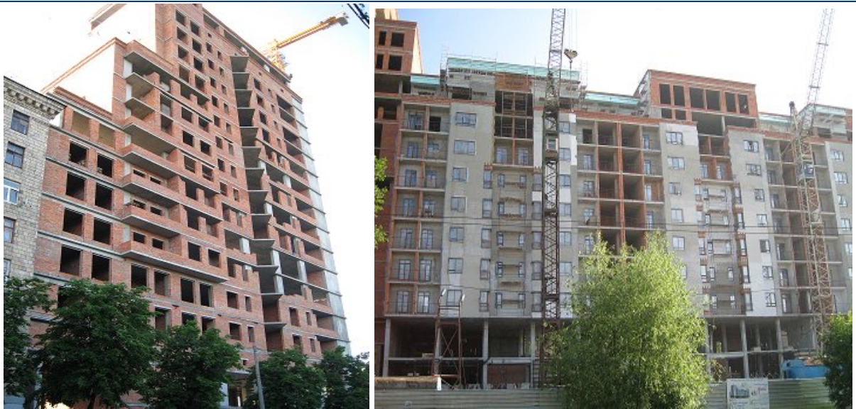
Хід робіт на об'єкті будівництва по пров. Банному в м. Харкові станом на 22.05.2009 р.
