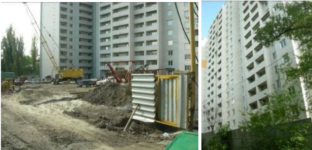
Об'єкт по вул. Дмитра Кедріна, в районі будинку №55, м. Дніпропетровськ станом на травень 2010 року
