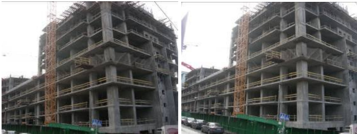
Будівельні роботи на об'єкті будівництва, обмеженого вулицями Предславинською, Ульянович та Червоноармійською станом на 17.11.2009 р.
