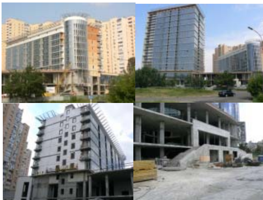
Будівельні роботи на об'єкті «Артеміда комплекс» за адресою м. Київ, перехрестя Дарницького бульвару та вул. Генерала Жмаченка станом на вересень 2010 р.
