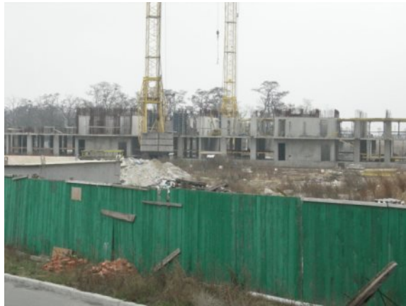
Рисунок 1. Стан будівництва житлових будинків у с. Чайці по вул. Коцюбинського, 29, 30 Київської області на початок 2010 р.
